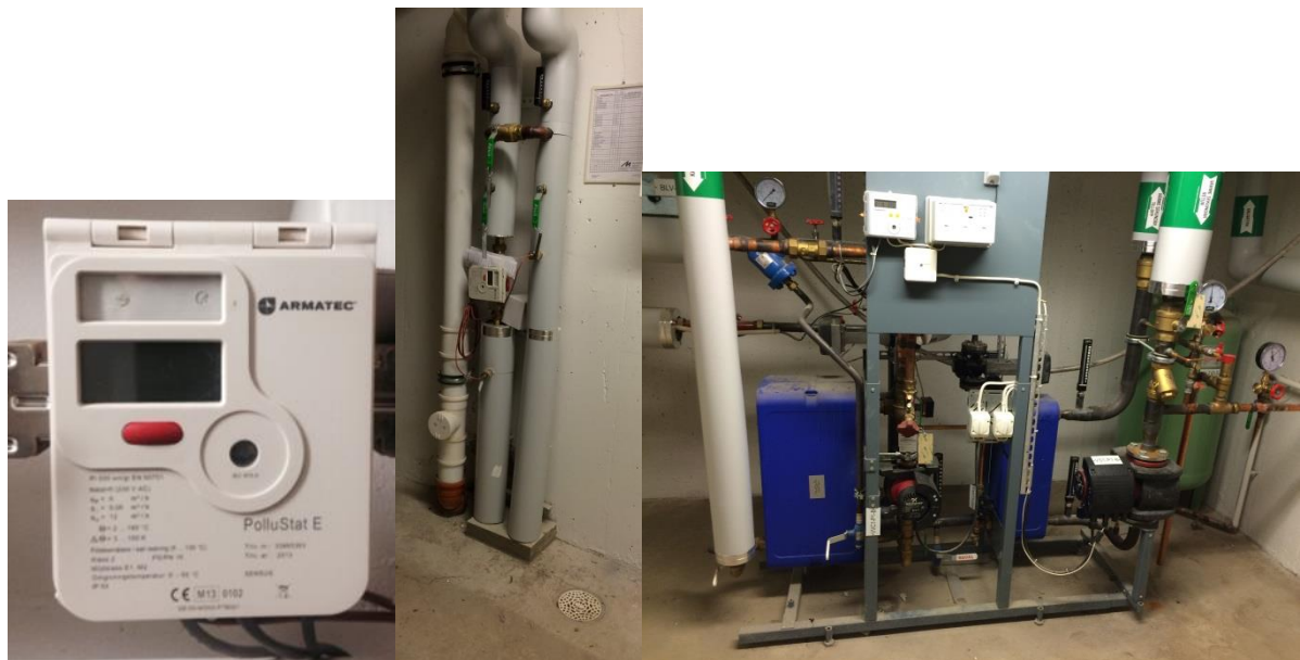
Figur 11 Energimätare färskvatten (kallvatten till SVX & förvämt vatten från SVX). Fjärrvärmecentralen till höger finns i samma rum.
