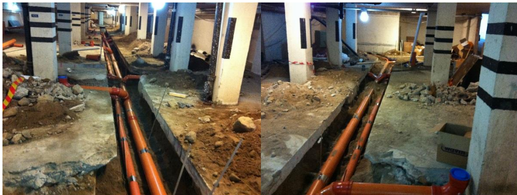
Figur 6 Spillvattenledningen i garaget innan gjutning av golvet, sett från undercentral (vänster) och mot UC (höger). Den tunnare ledningen är dagvattenledning för garaget. Kallvattenledningen till och från undercentralen ligger i detta dike också (inte ditlagd på dessa foton)
